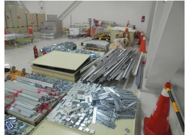
物料堆放凌亂未固定
