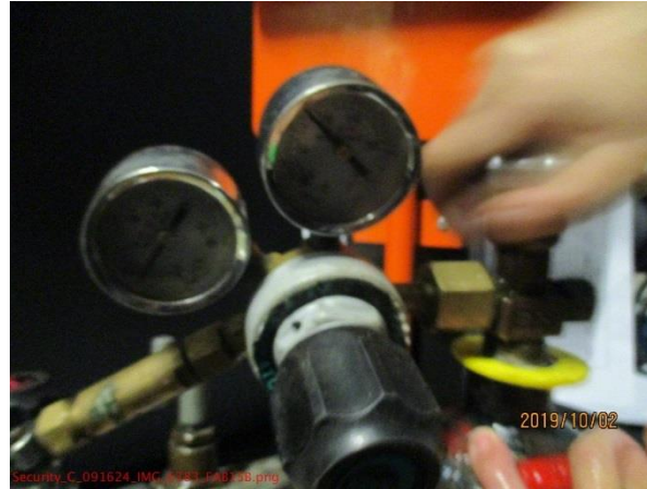
檢查壓力錶正常
