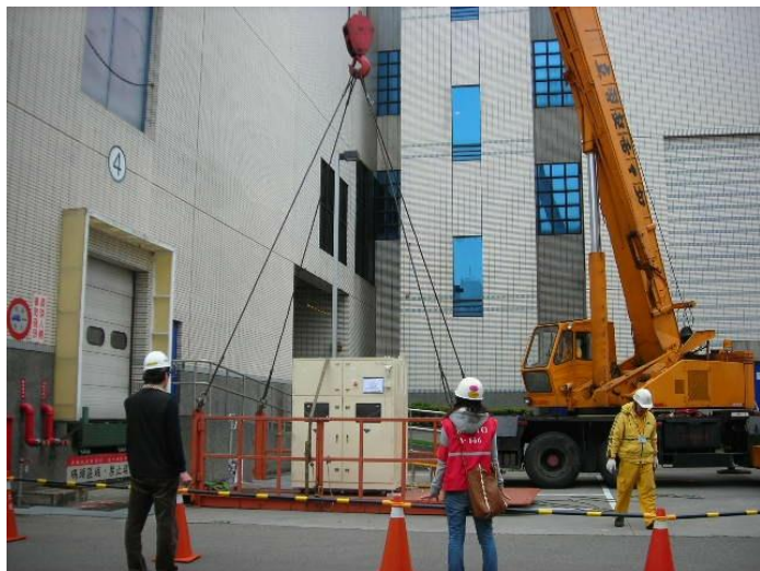
禁止使用移動式吊裝平台
