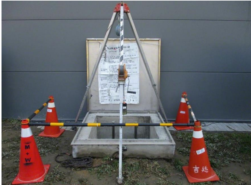
地下柴油儲槽
