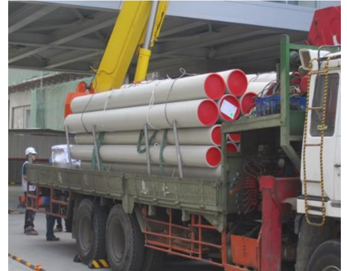
載運管件車輛之側擋高度 不足
